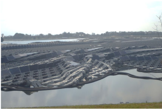
■ 写真9 吹き寄せられた水上太陽光パネル
