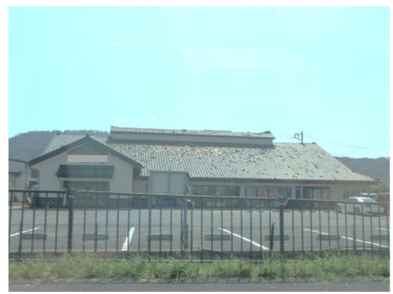
■ 写真 16 屋根瓦の落下した商業施設
