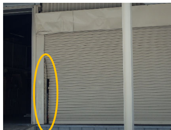
■ 写真4 破損したシャッター
