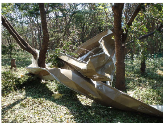
■ 写真3 隣地より飛来した屋根材
