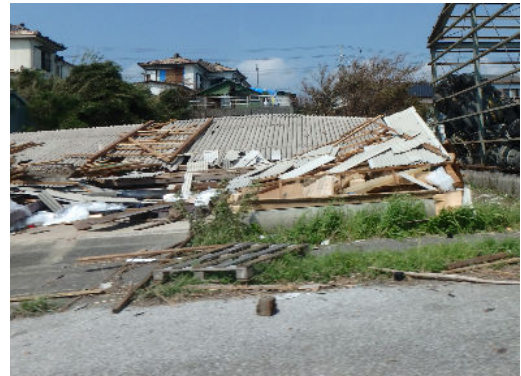
■ 写真 18 倒壊した木造倉庫
