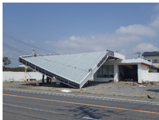
■ 写真 20 屋根の崩落したガソリンスタンド
