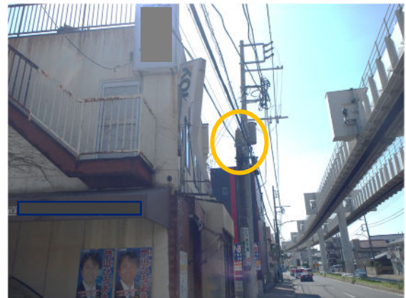
■ 写真2 折損した電柱(修復済)
