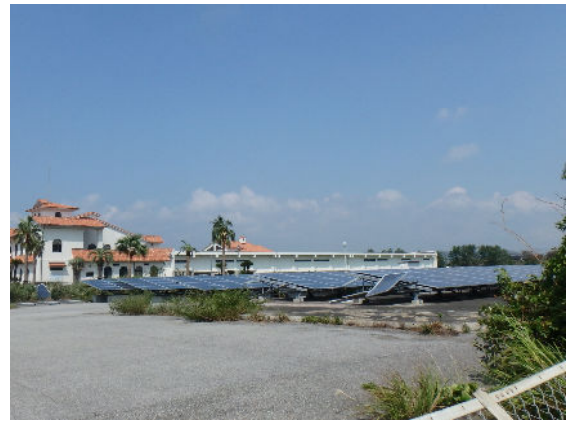
■ 写真 26 破損した太陽光パネル
