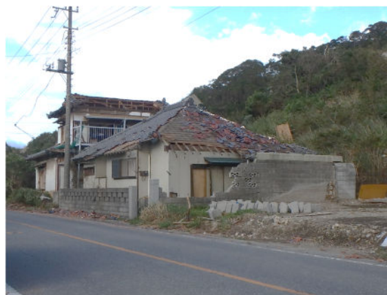
■ 写真 24 屋根が飛散・崩落した家屋
