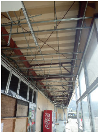
■ 写真 15 崩落した吊り天井
