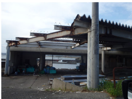
■ 写真 19 飛散した金属屋根
