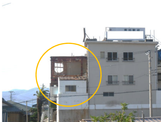
■ 写真 23 屋根が母屋ごと飛散した施設
