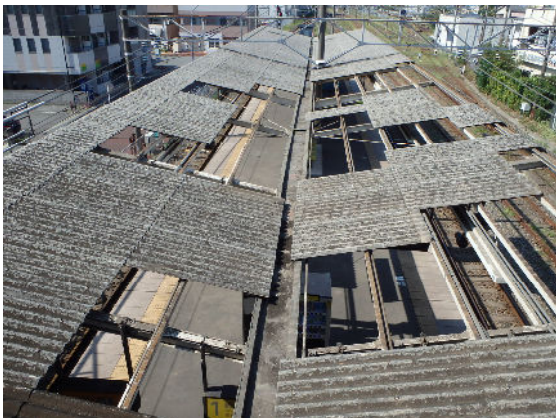
■ 写真1 屋根の飛散した駅舎
