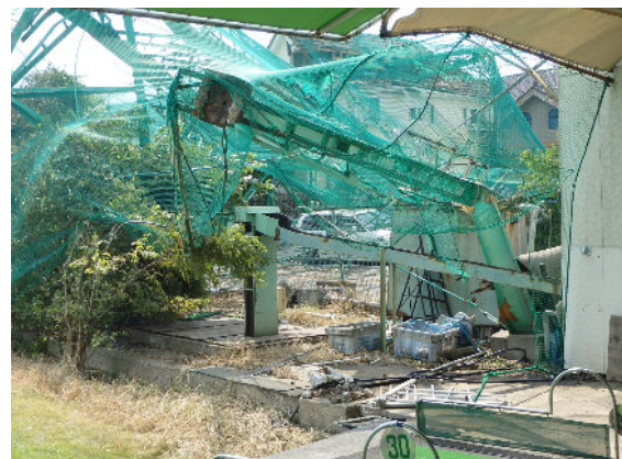
■ 写真 8 倒壊したゴルフネットの基礎部分
