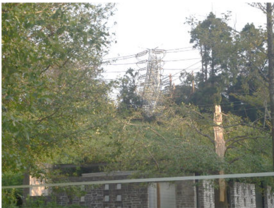
■ 写真11 倒壊した鉄塔
