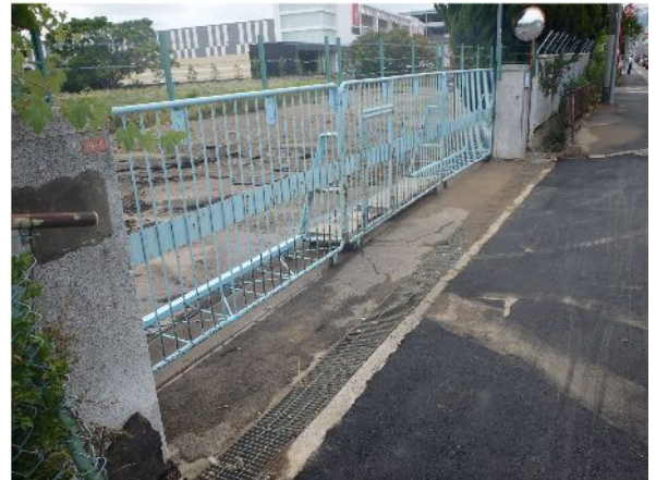
写真2 水道管破裂により浸水した敷地
