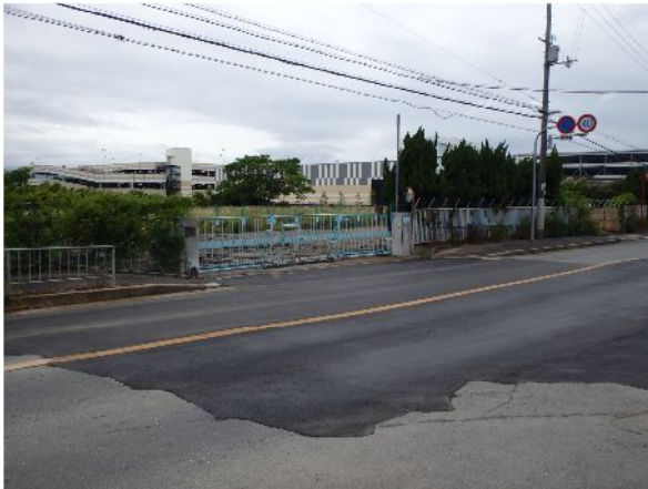
写真1 水道管破裂箇所（復旧済）
