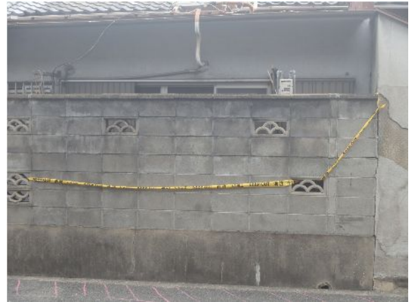
写真8 倒壊が懸念されるブロック塀
