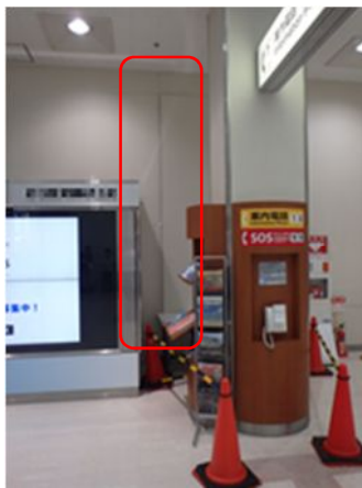
写真 15 内壁ボードの破損 (空港)
