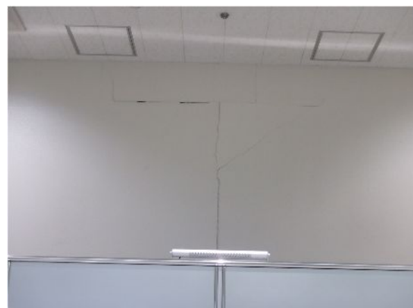
写真 16 内壁ボードの破損 (空港)
