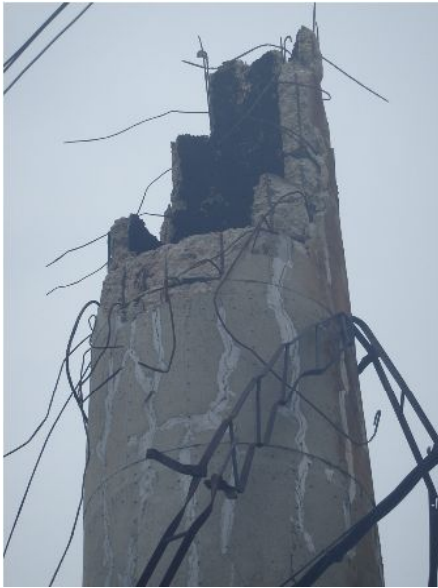
写真 13 折損したコンクリート製煙突 (枚方市内の入浴施設)
