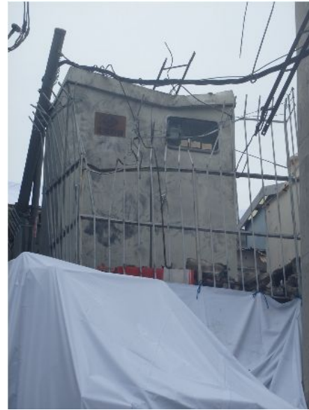
写真 14 破損したキュービクル (枚方市内の入浴施設)
