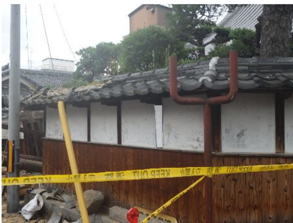
写真5 門の倒壊、土壁塀の瓦落下
