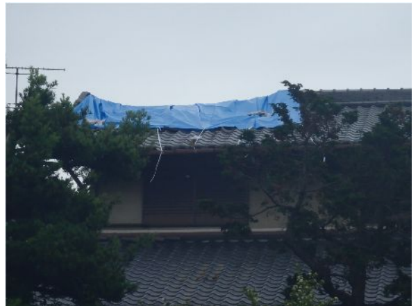
写真10 ブルーシートが掛けられた屋根
