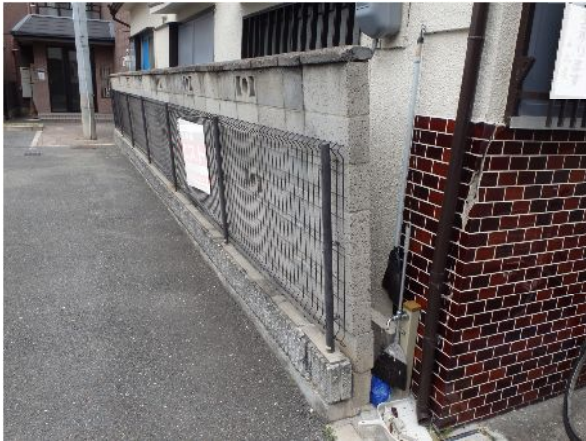
写真7 傾斜したブロック塀
