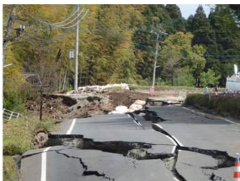
■写真 5 道路の亀裂・陥没
