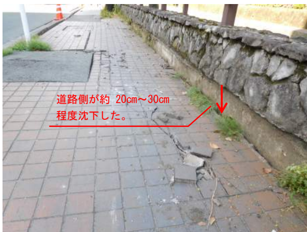
■写真3 熊本城周辺の地盤沈下
