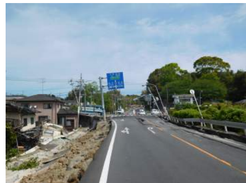
■写真 6 道路の法面の崩壊
