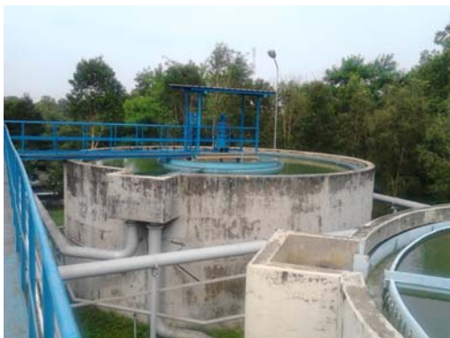
■写真4 KIIC の排水処理設備（弊社撮影）
