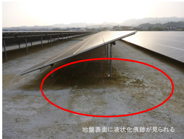
■写真4 メガソーラー敷地内の液状化痕跡
