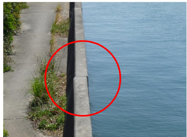
■写真2 埋立地における護岸のずれ
