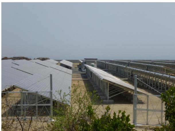
■写真3 埋立地に敷設されたメガソーラー
